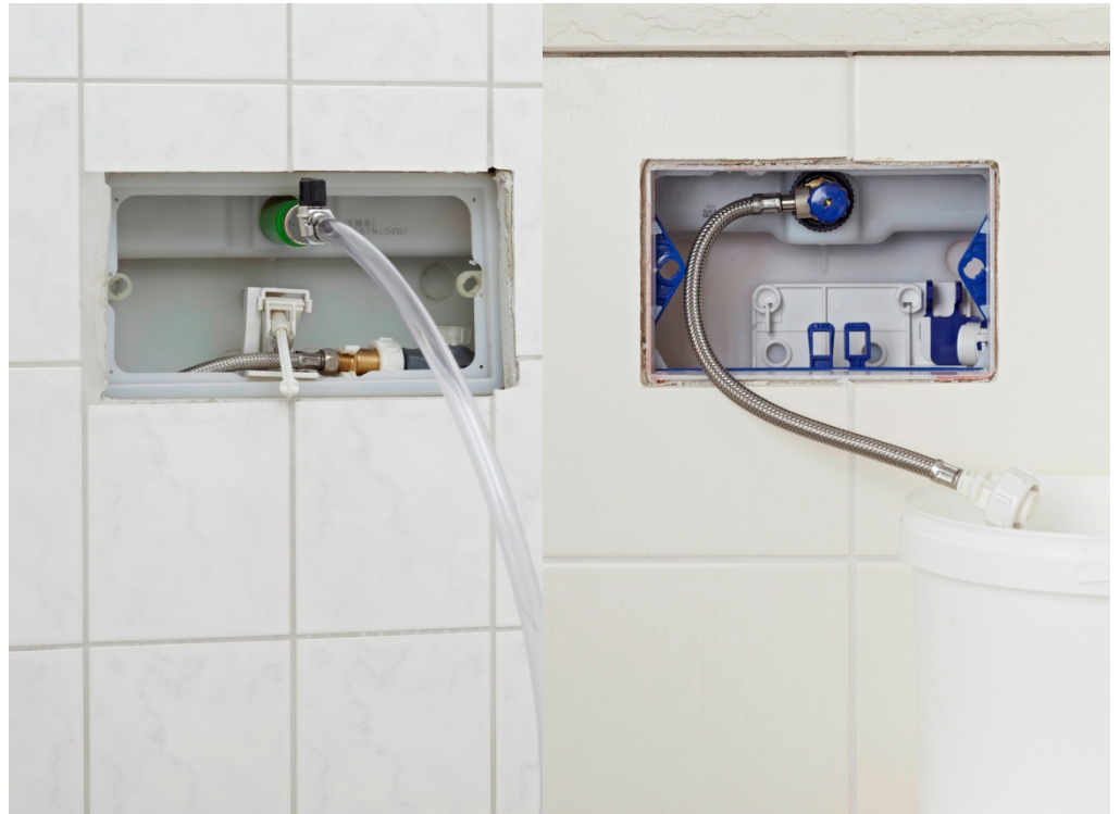
Abb.13: WC-Spülkasten (demontiertes Eckventil) mit Baustopfen und Spülmatur
