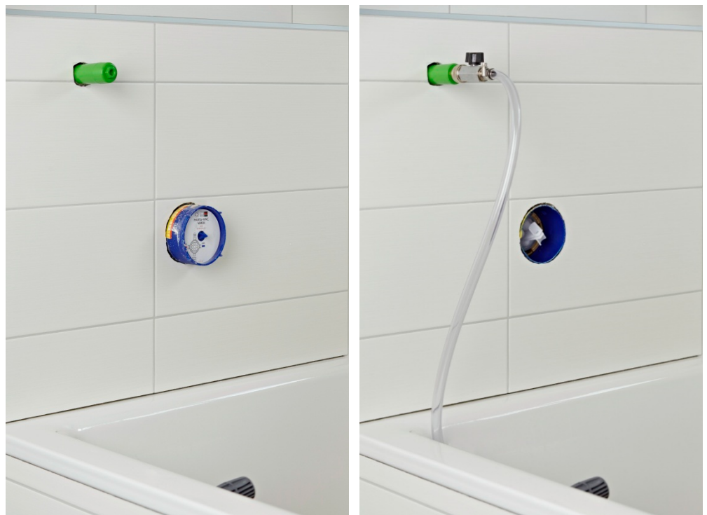
Abb. D-12: Entnahmestelle an Badewannen-Armatur mit Baustopfen und Spülarmatur, sowie Spüleinsatz des Armaturenerstellers in der Unterputzarmatur zur getrennten Spülung der Kalt-/Warm-Wasserleitungen.
