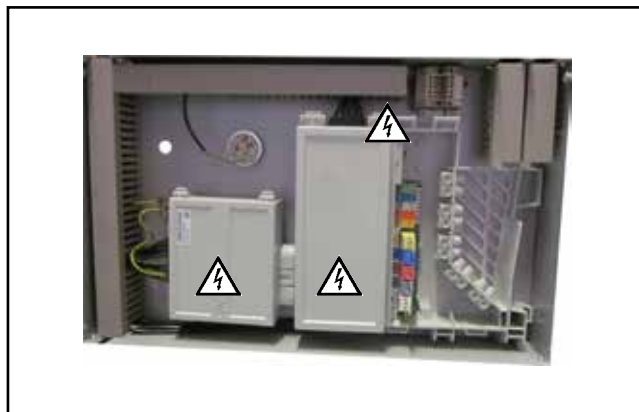
Bild: Steuerungskasten Gefahr durch elektrische Spannung
