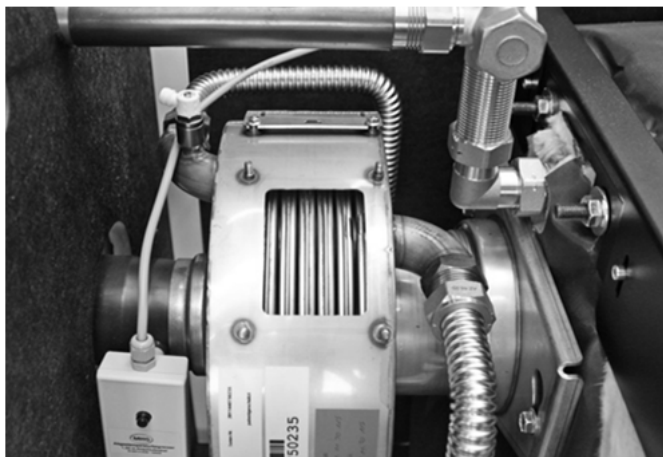
Abb. 68: Reinigungsöffnung des RWT
