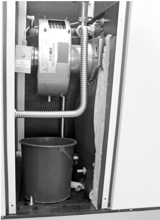
Abb. 69: Zur Reinigung vorbereiteter RWT
