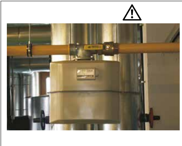
Bild: Gasanschluss: Gefahr von Vergiftung und Explosionsgefahr durch ausströmendes Gas.
