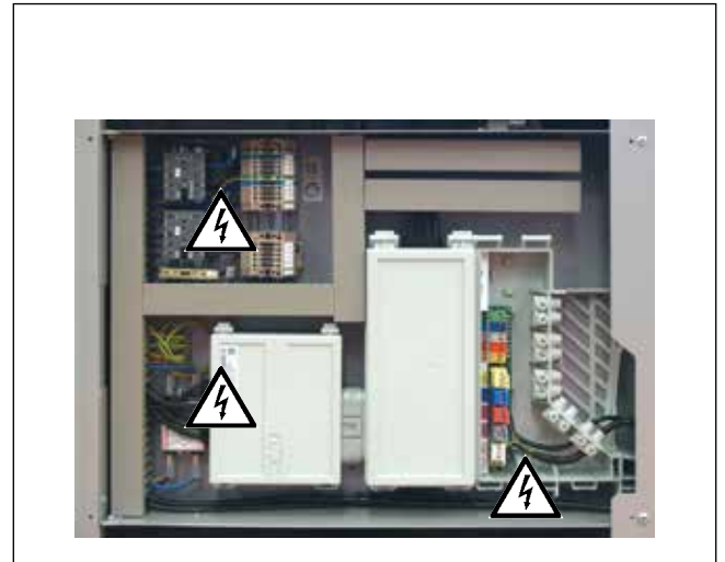
Bild: Steuerungskasten Gefahr durch elektrische Spannung
