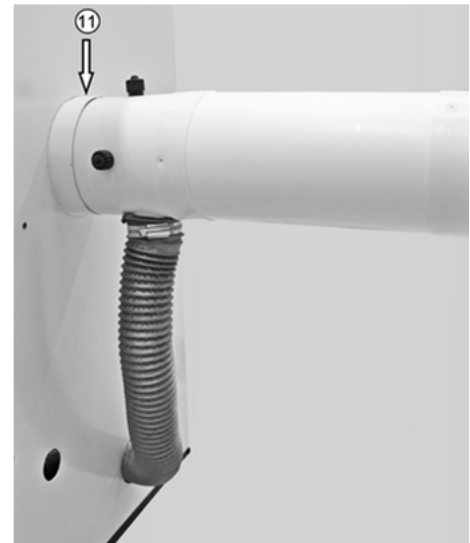
Abb./Fig. 14: Am Kessel montierte Abgasleitung Conduit de fumée monté sur la chaudière
