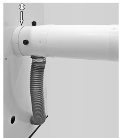
Abb./Fig. 20: Am Kessel montierte Abgasleitung Conduit de fumée monté sur la chaudière
