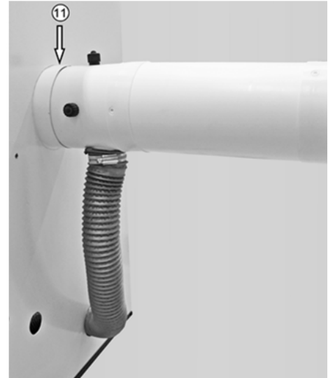
Abb./Fig. 20: Conduit de fumée monté sur la chaudière
